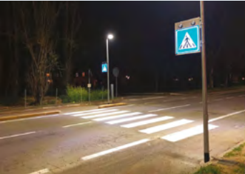
Attraversamento pedonale di Via Savena Superiore illuminato a led Marzo 2021
